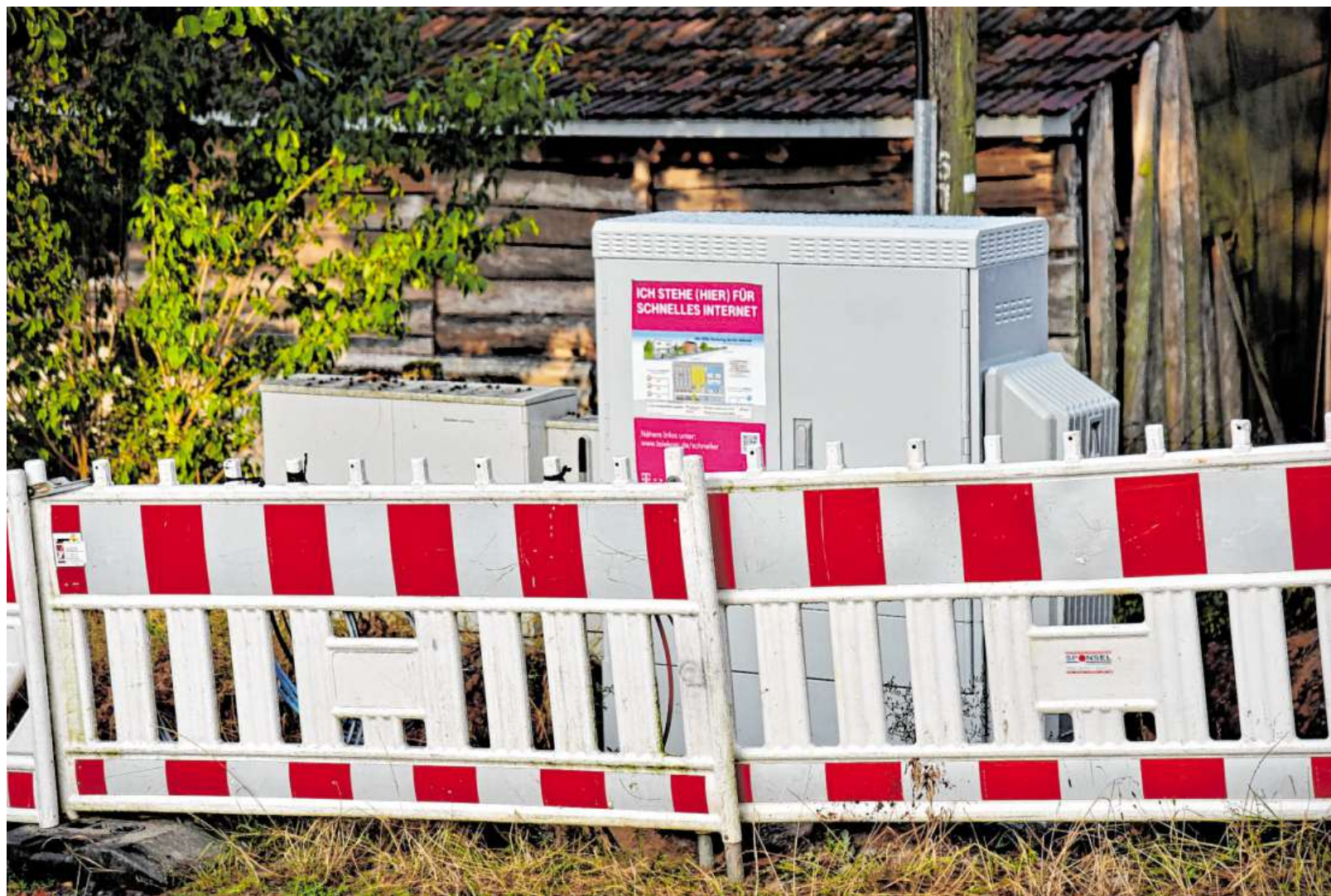
Noch sieht es in Höhefeld im Moment nicht nach Fertigstellung aller notwendigen Baumaßnahmen für den Breitbandanschluss der Ortschaft aus.
