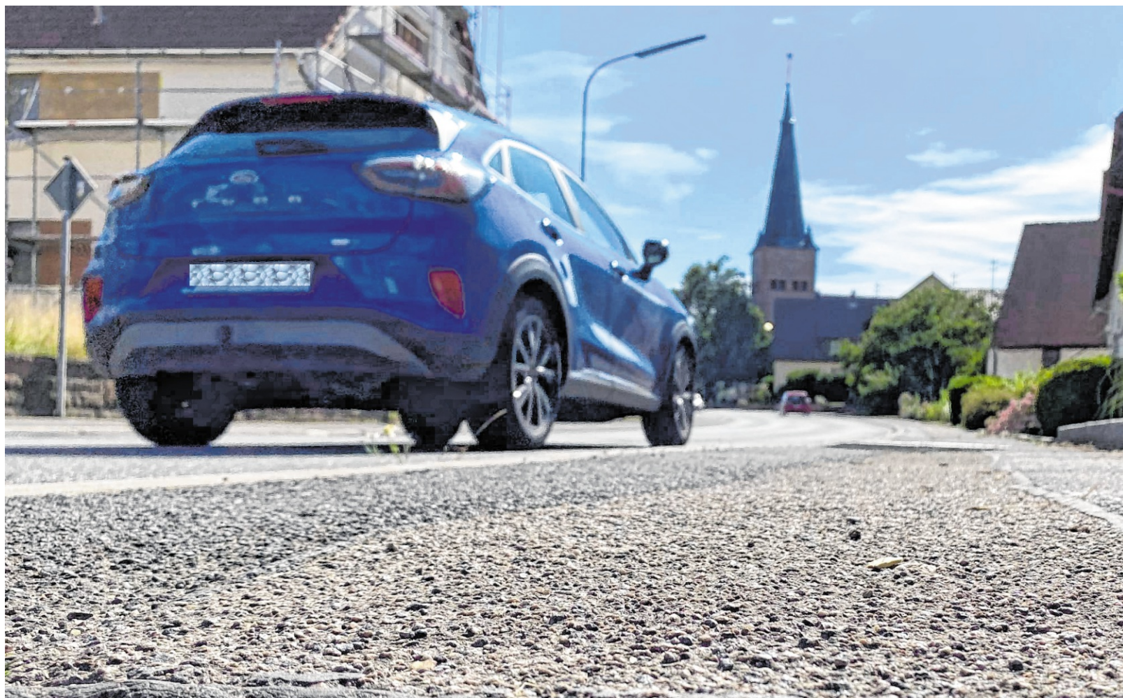
Schadstoffe im Straßenbelag der Nassiger Ortsdurchfahrt könnten das Nahwärmeprojekt gefährden.
